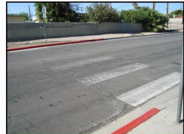
No hay rampas de acera a lo largo de la Avenida Wenger ten la escuela primaria Crestwood
