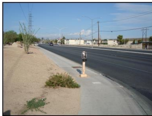
Botón de paso de peatones y parche sin pavimentar en el centro de la acera
