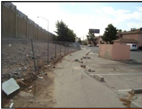
Escombros, piedras y basura en el sendero multiuso adyacente a la U.S. 95
